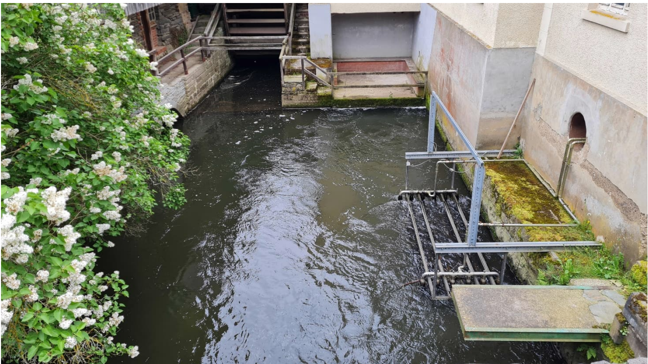
Abb. 16: Plattenwärmetauscher im Mühlgraben der Weißen Elster.
