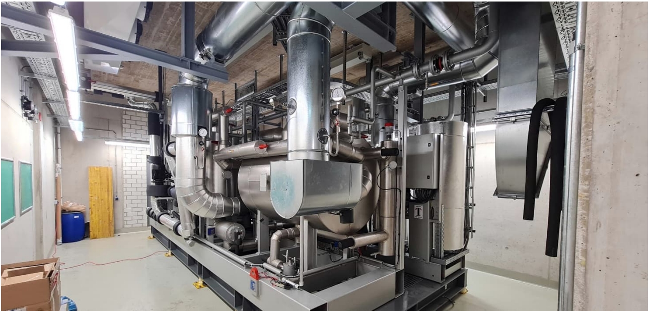
Abb. 15: Eine der drei Großwärmepumpen in Rosenheim.
