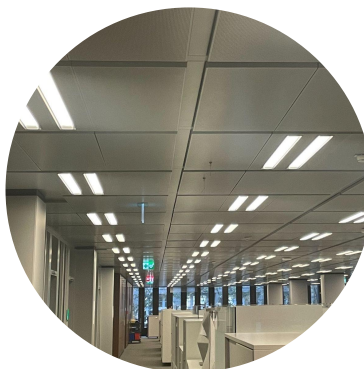
Abhängedecken und Leuchten
